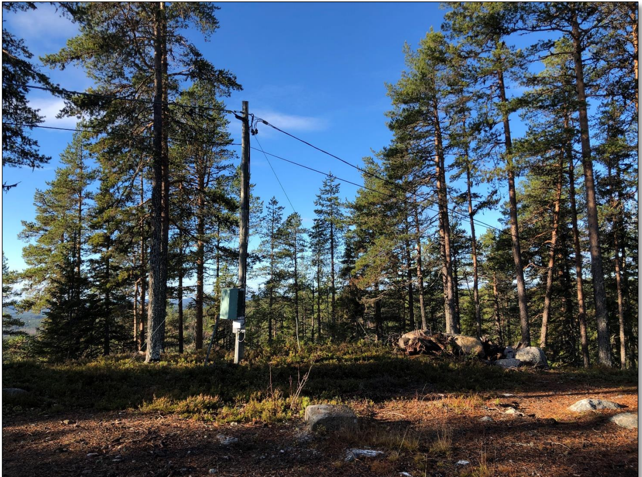
Luftledning för strömförsörjning av mobilmast
