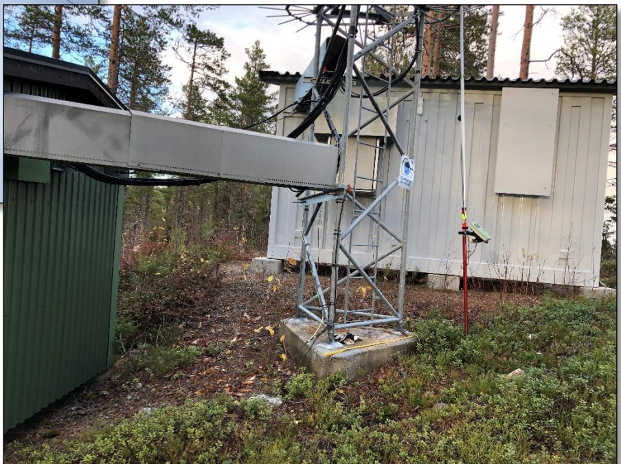
Mobilmast i fackverk med tillhörande teknikbodar
